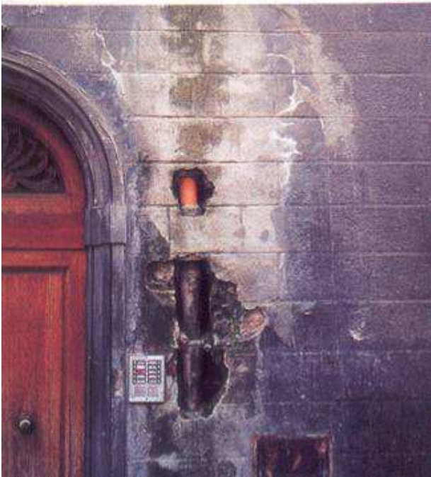
Muschi causati da perdite localizzate dell'impianto di smaltimento acque meteoriche
