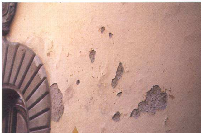
Sollevamenti su intonaci cementizi della pellicola pittorica con resine acriliche; tali fenomeni sono causati dagli stati tensionali instaurati tra intonaco e colore per forti gradienti termici
