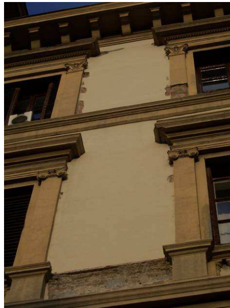
Degrado di porzioni di pietra artificiale che mostra l'ossatura in mattoni
